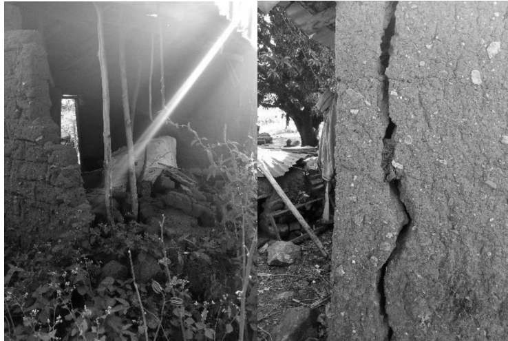
Planche 1 : Fissures de bâtiments dues aux vibrations ressenties
